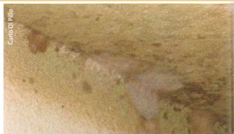
Foto di muffe sviluppatesi lungo un ponte termico: si noti la linea di arresto della crescita in basso a sinistra.
